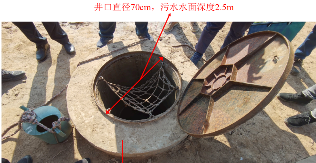
P65-15污水检测井
